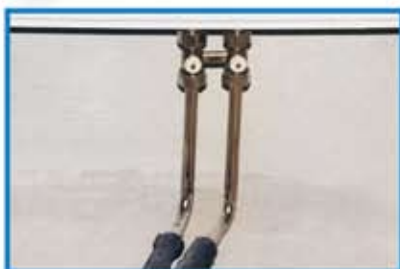
Instalacija s priključnim lukovima
